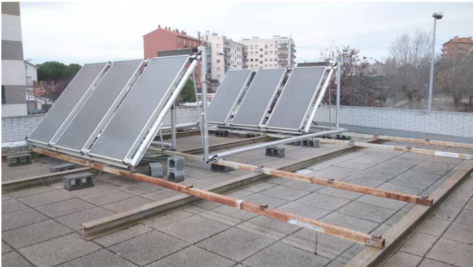
Vista plaques per a contribució solar (ACS i calefacció)
