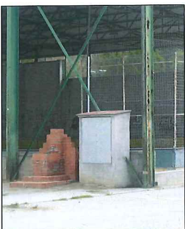
FONT I QUADRE ELÈCTRIC EXISTENT
